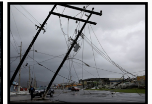
Daños causados al sistema eléctrico de PR
