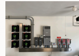
Sistema Diseñado Integrado por Terra Alta Engineering eliminando costo energético e integrado con baterías de litio y generador de emergencia
